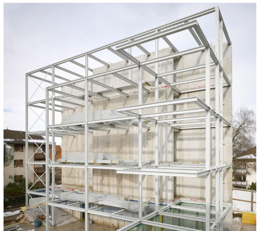
Das Stahlskelett greift von der zentralen Betonwand aus und bildet zwei Haushälften. BILD GAUCH & SCHWARTZ
